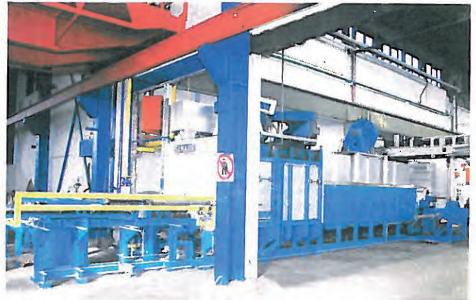
Der neue BlockanwärmoFen ist seit Oktober 2007 voll in Betrieb.
